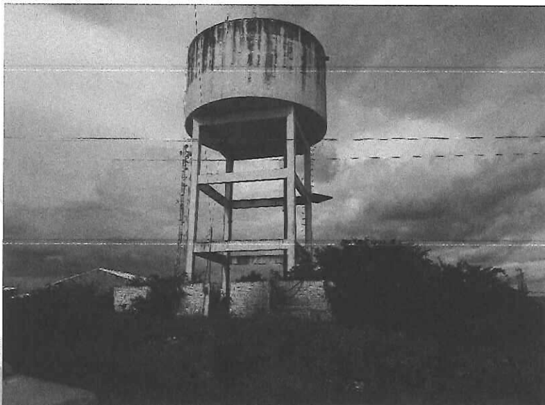
FIGURA 25 - RESERVATORIO ELEVADO EXISTENTE
